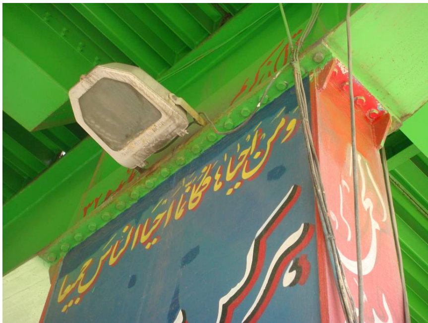
آسیب دیدگی رنگ و زنگ زدگی ورقهای اتصال پایه به سرپایه
