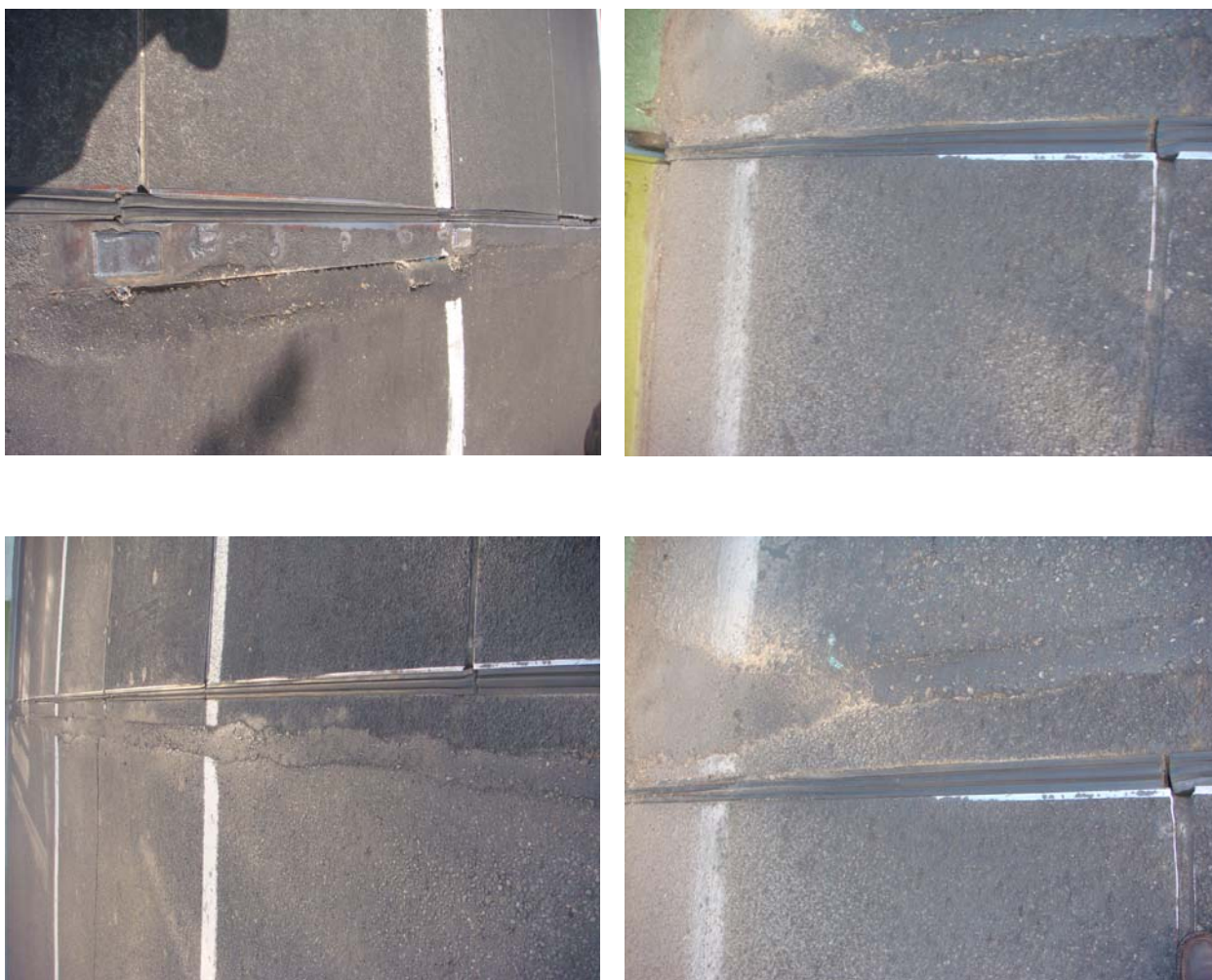
شکل ۳-۲- آسیب‌های درز انبساط انتهایی
