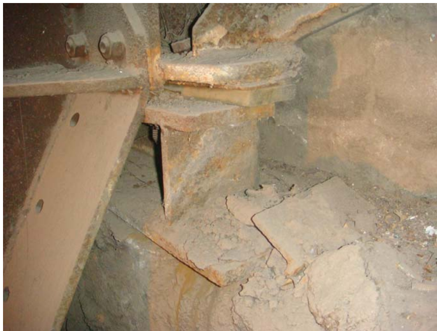
شکل ۴-۵ - آسیب دیدگی نشیمن تیر در محل کوله
