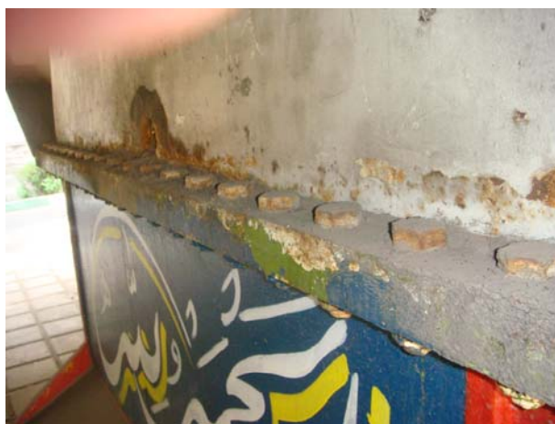
شکل ۳-۵ - زنگ‌زدگی پیچ‌های اتصال سرپایه به پایه
