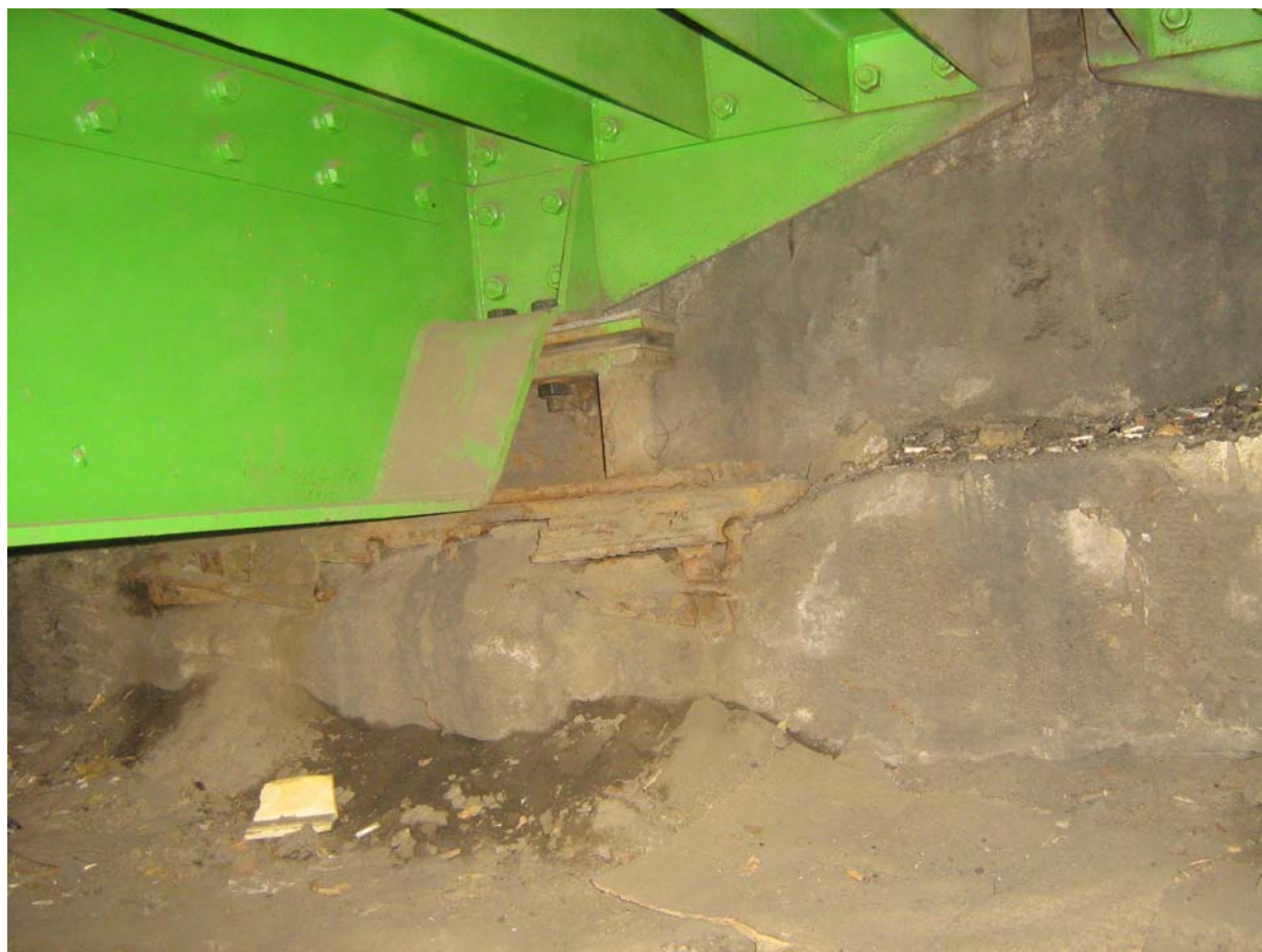
شکل ۱- خرابی و زنگ زدگی شدید تکیه‌گاه در محل نشیمن انتهایی پل
