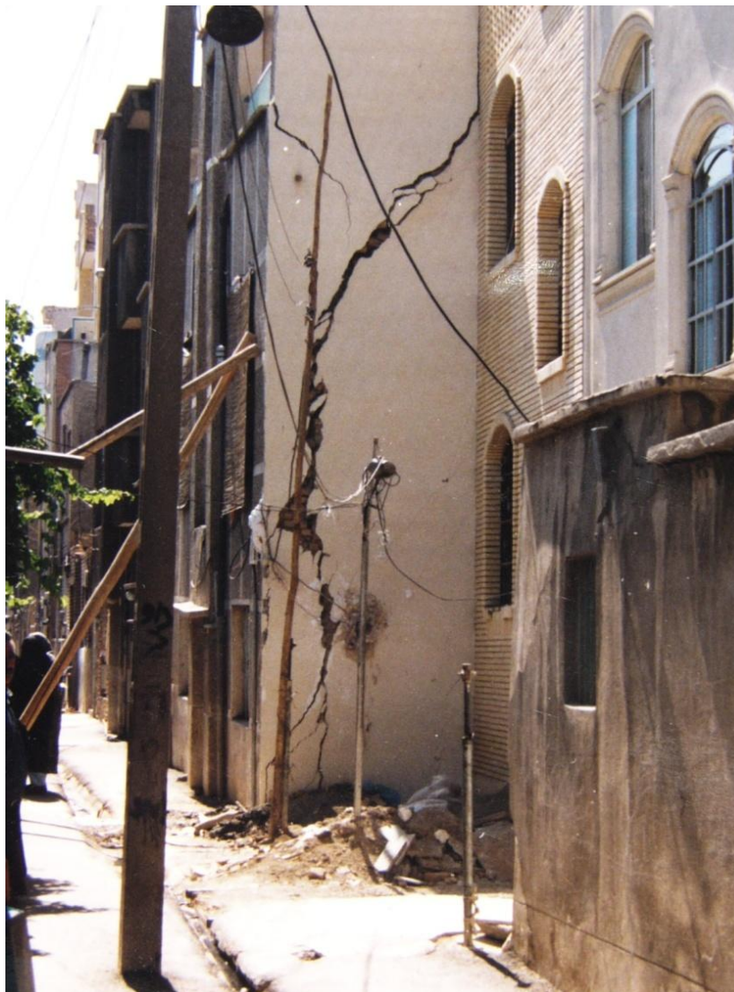
تصویر شماره 4 - ترک ایجاد شده در ساختمان موجود، در کنار ساختمان جدید
