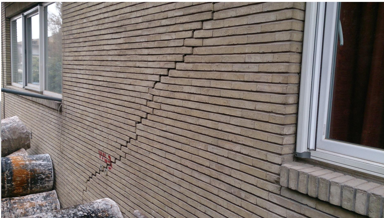
تصویر شماره 13 - ترک ایجاد شده در دیوار ، در اثر گود برداری در نزدیکی ساختمان
