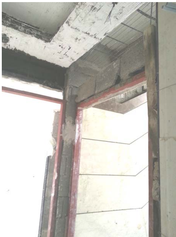
شکل ۱۰- عدم اجرای نعل درگاه یا کمرکش برای درب های داخلی ساختمان
