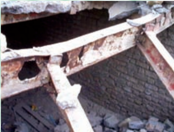
اتصال نادرست مفصلی تیر و ستون موجب تخریب سازه در زلزله بم شده است.
