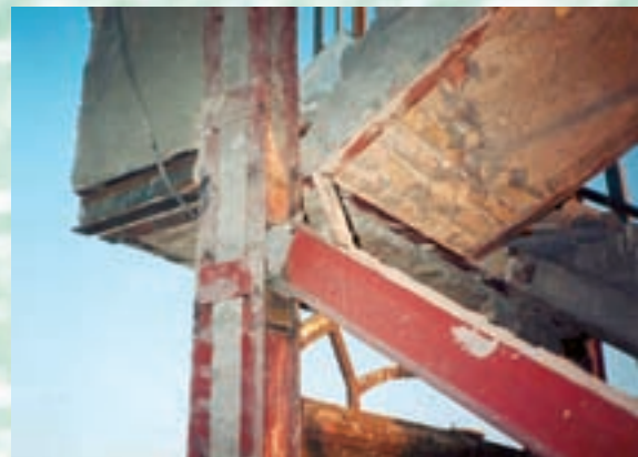
ضعف اتصال مفصلی تیر و ستون موجب تخریب سازه در زلزله شده است.
