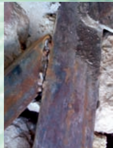
گسیختگی در اثر اتصال مهاربند به ستون بدون ورق اتصال
