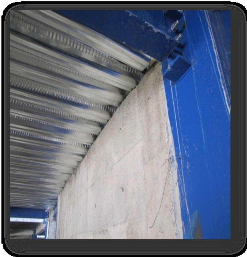
شکل (۲۱) ورق های عرشه فولادی بطور غیرصحیح بر روی دیوار بتنی قرار گرفته است.
