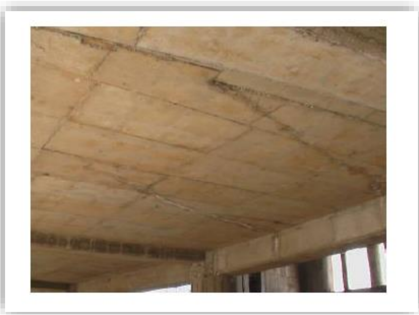
ترک خوردگی ناشی از تیرهای نزدیک به هم
