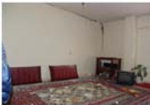
لغزش سقف روی دیوار
