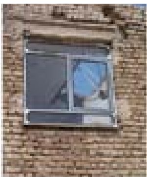
ترک دیوار سازه ای
