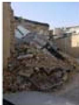
نمونه از تخریب یک واحد مسکونی
