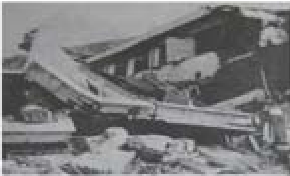
خرابی طره های بزرگ در ساختمان بیمارستان رودبار
