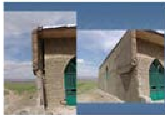
جابجایی خارج از صفحه دیوار
