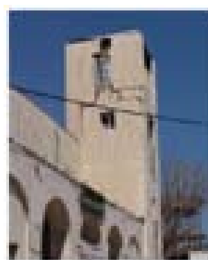
آسیب شدید قسمتی از ساختمان شهرداری
