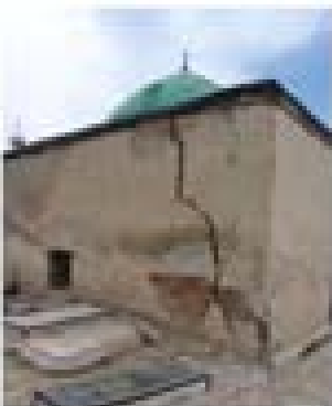
ترک شدید دیوار سازه ای
