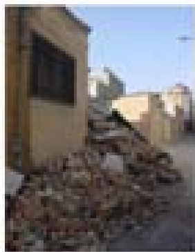
نمونه از تخریب یک واحد مسکونی
