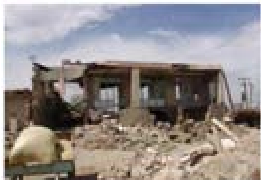
تخریب کلی قسمتی از یک ساختمان روستایی
