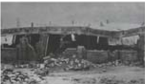
رفتار بسیار خوب کلاف افقی زیر سقف (در منجیل) که علی رغم ریزش دیوار های اطراف از سقوط و فرو ریزی سقف جلوگیری کرده است.
