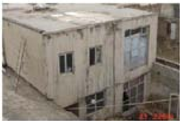
ج) ساختمان آسیب دیده در زلزله
