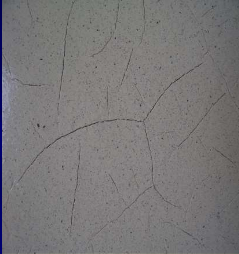
ترک خوردگی سطحی (Checking)
