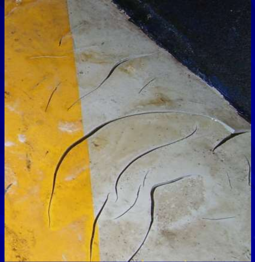
ترک خوردگی عمیق (Cracking)
