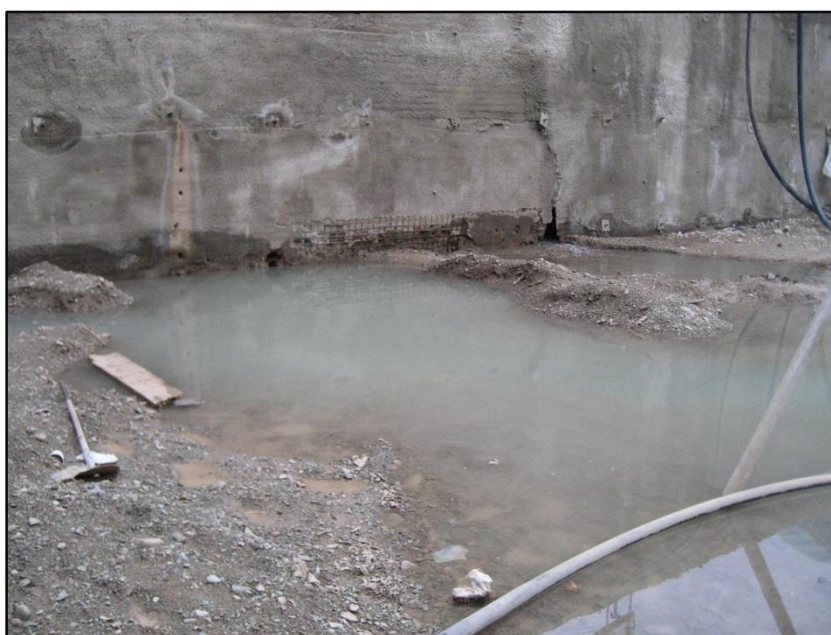
شکل ۹: هجوم آب زیرزمینی به داخل گود و ایجاد اشکال در روند اجرایی پروژه
