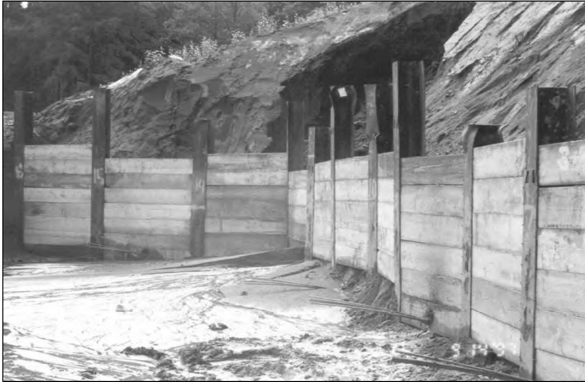
شکل ۱۶: فرسایش شیب به دلیل عدم اجرای پوشش محافظتی
