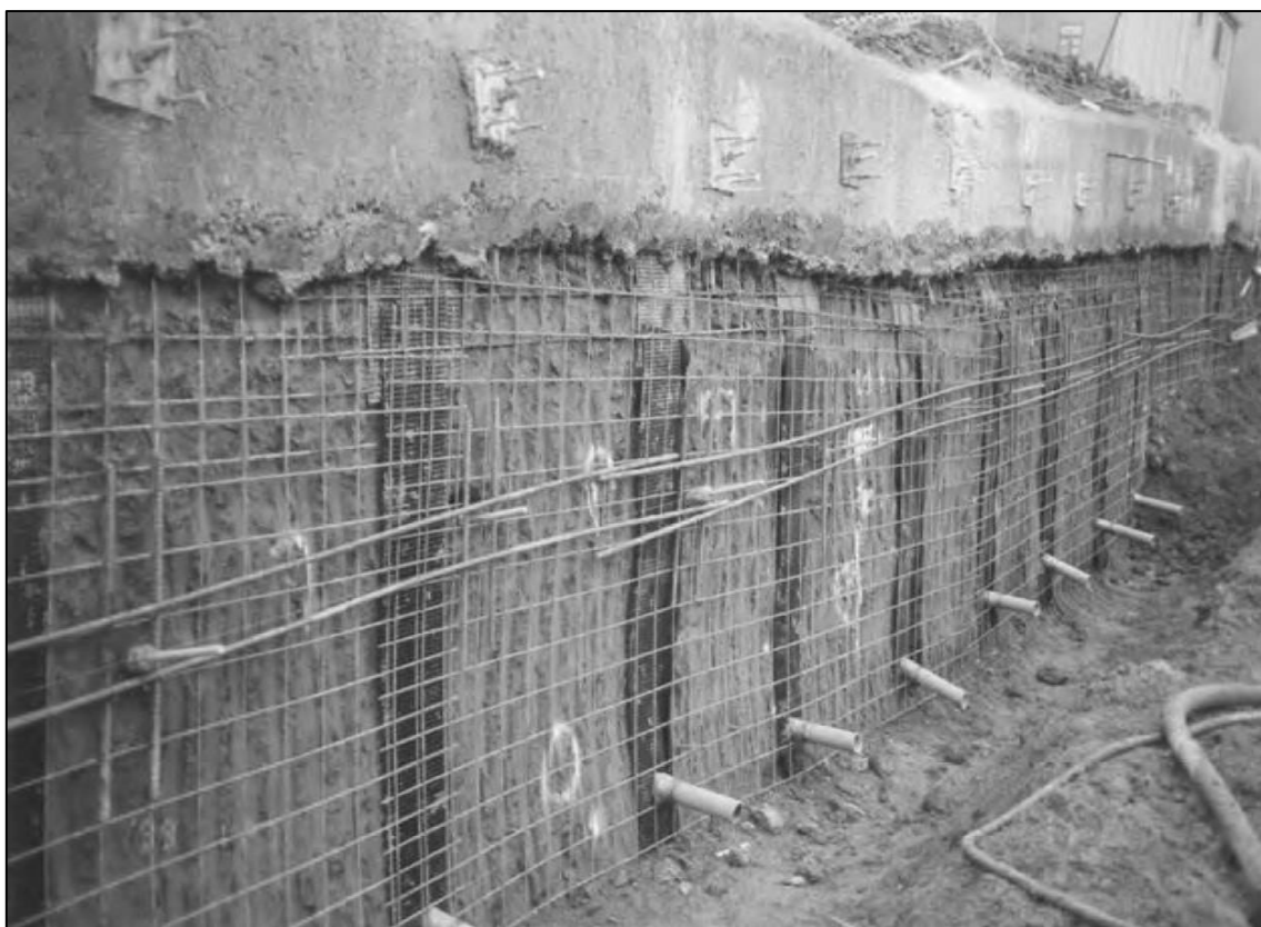
شکل ۲۱: لوله‌های جمع آوری و هدایت آب‌های زهکشی شده
