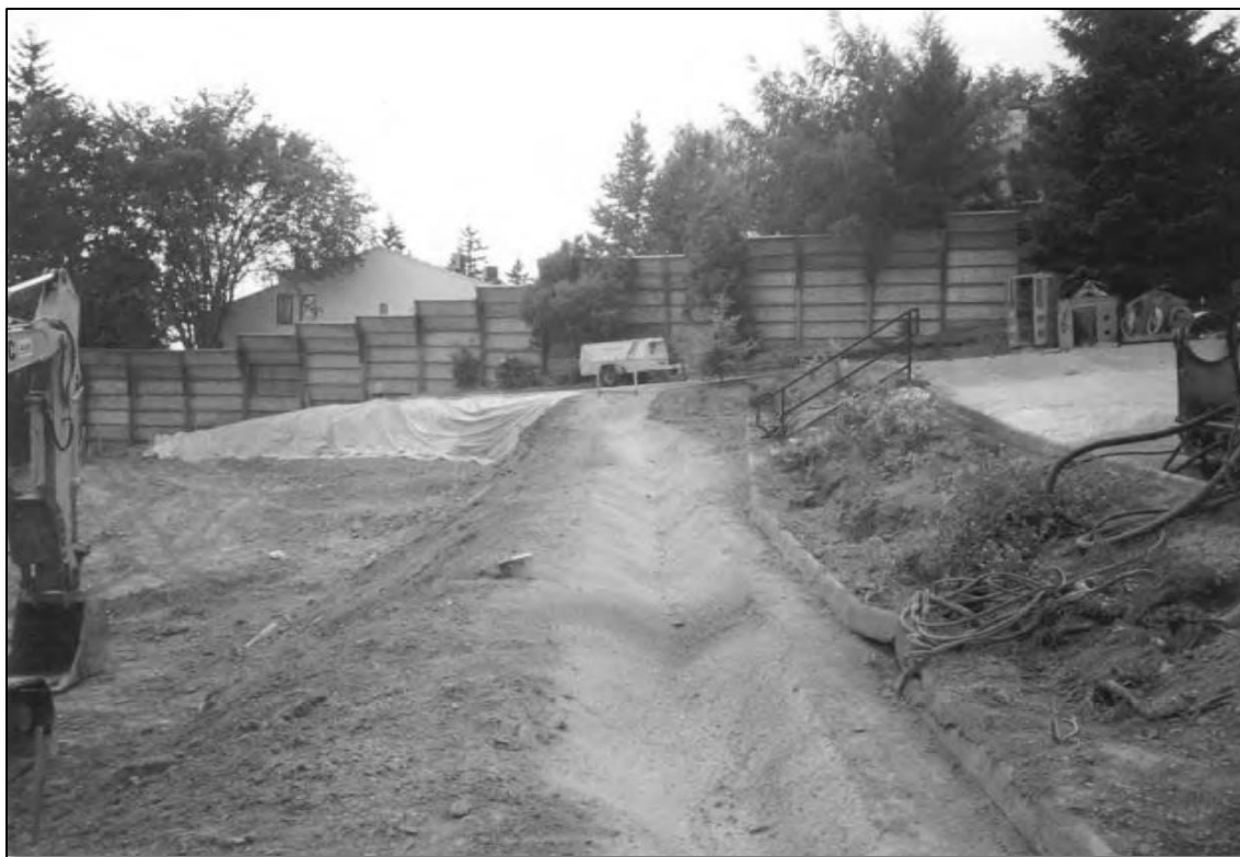
شکل ۱۴: موانع و کانال‌هایی که در اطراف محل گودبرداری احداث شده اند
