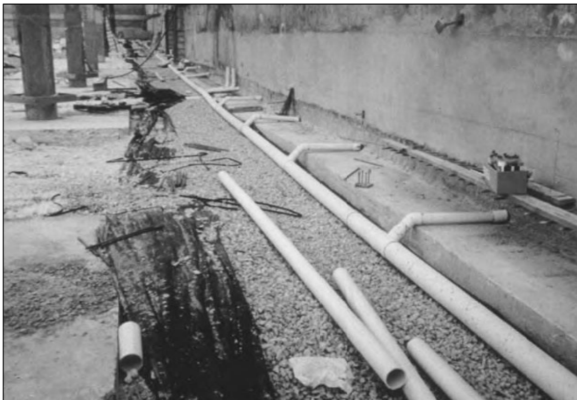
شکل ۲۲: لوله‌های انتقال آب به یک سیستم جمع آوری کلی متصل شده‌اند
