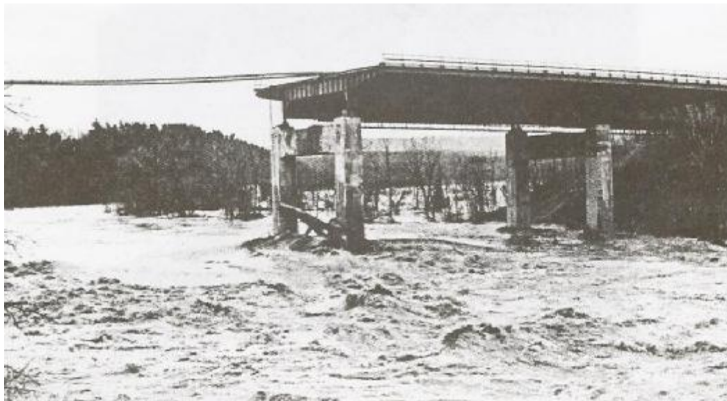
شکل (۲-۱۲) پل Schoharie Creek (۱۵ دقیقه بعد از شکست اولیه)
