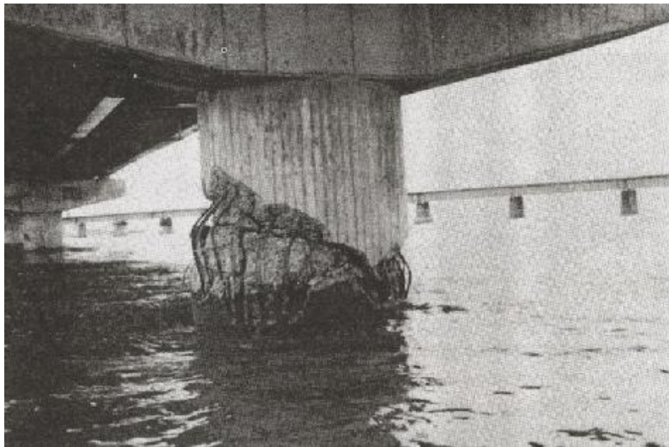
شکل (۲-۲) آسیب‌های وارد بر پایه‌های بتن‌آرمه پل شینرونومی در اثر زلزله اوراگاوا - اوکی، ۱۹۸۲
