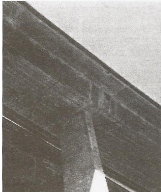
شکل (۱۱-۲) ترک در عرشه پل Reuss در اثر نشست فونداسیون
