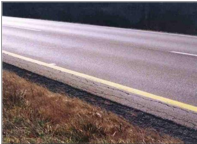
شکل ۷- ترک برشی لبه
