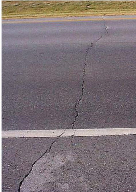
شکل ۲- ترک خوردگی عرضی
