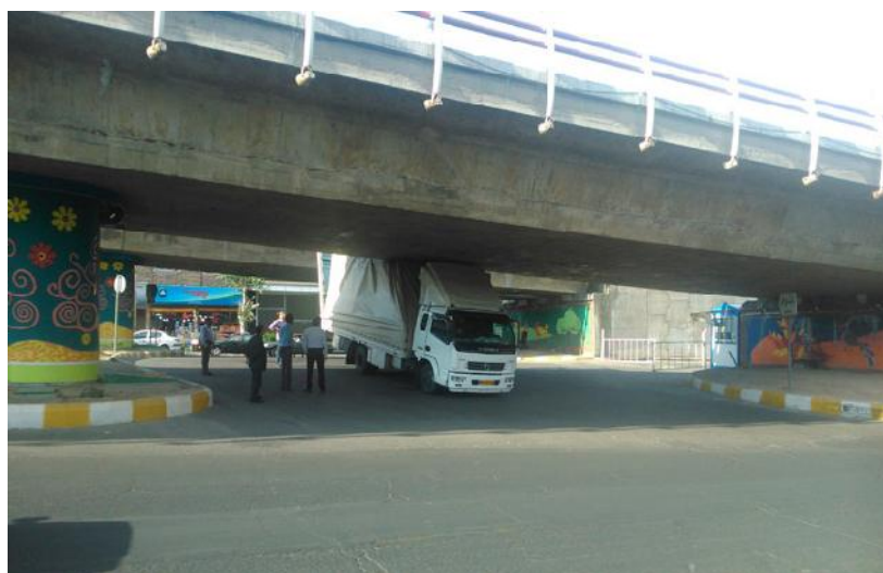
تصویر ۱۵- عدم رعایت ارتفاع مفید پل ( دهانه های انتهایی )
