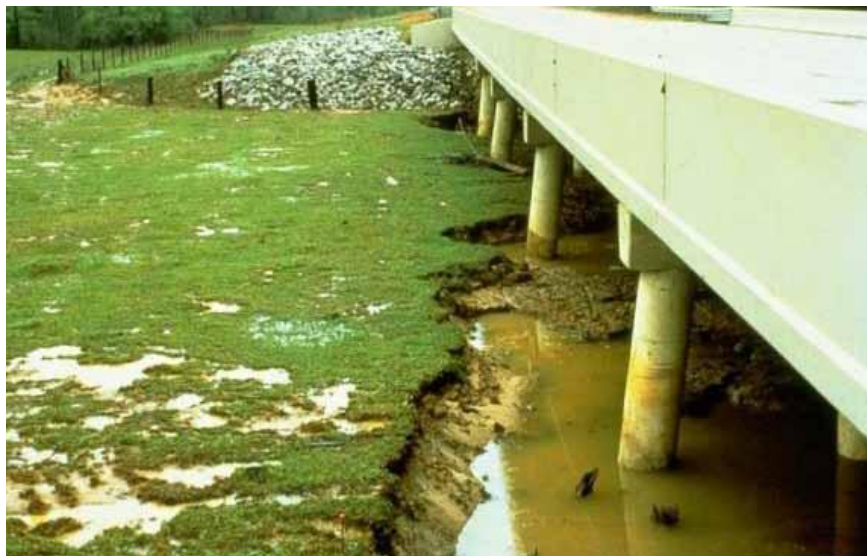
تصویر ۱۸- فرسایش موضعی پایه های پل
