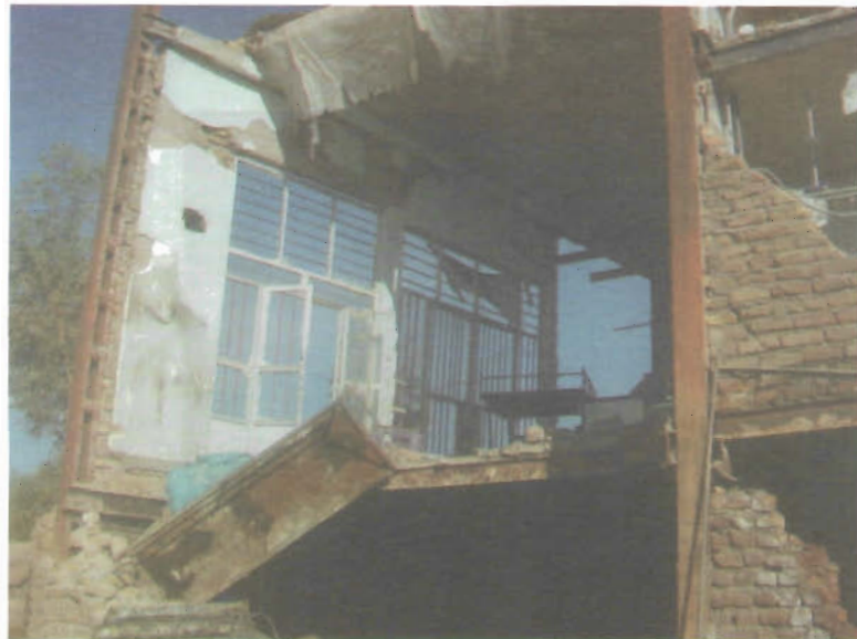
عدم اتصال صحیح دیوار آجری به ستون فلزی
