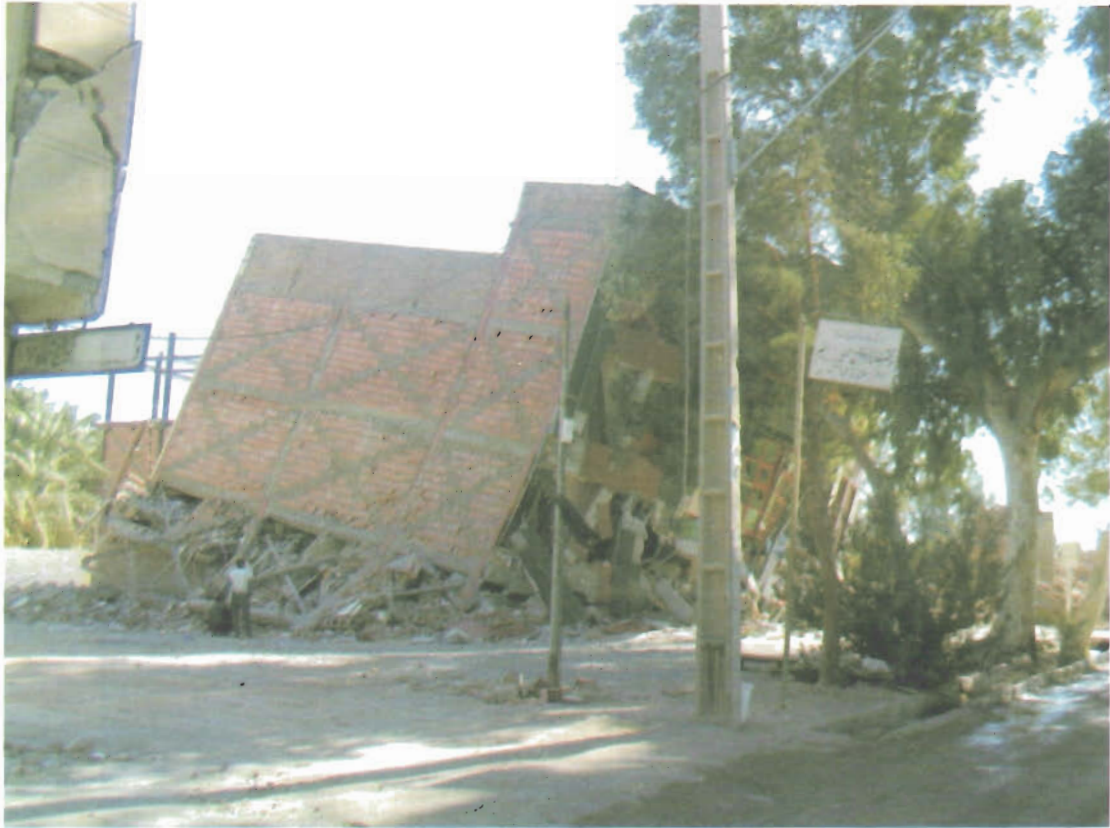
علت تخریب: اتصالات ساختمان در جهت خمشی به صورت مفصلی اجرا گردیده است
