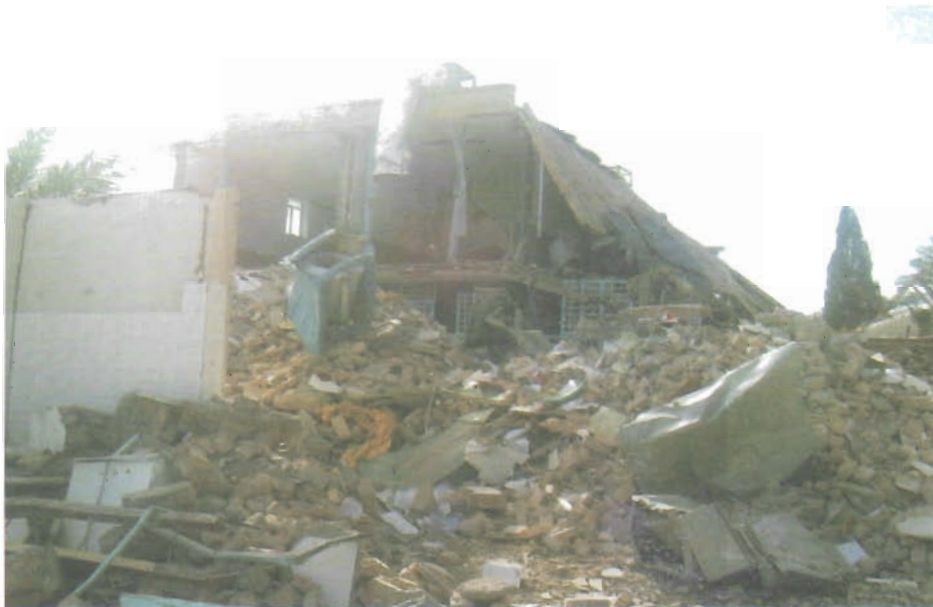
عدم کلاف بندی صحیح در ساختمانهای ساخته شده یا مصالح بنایی
