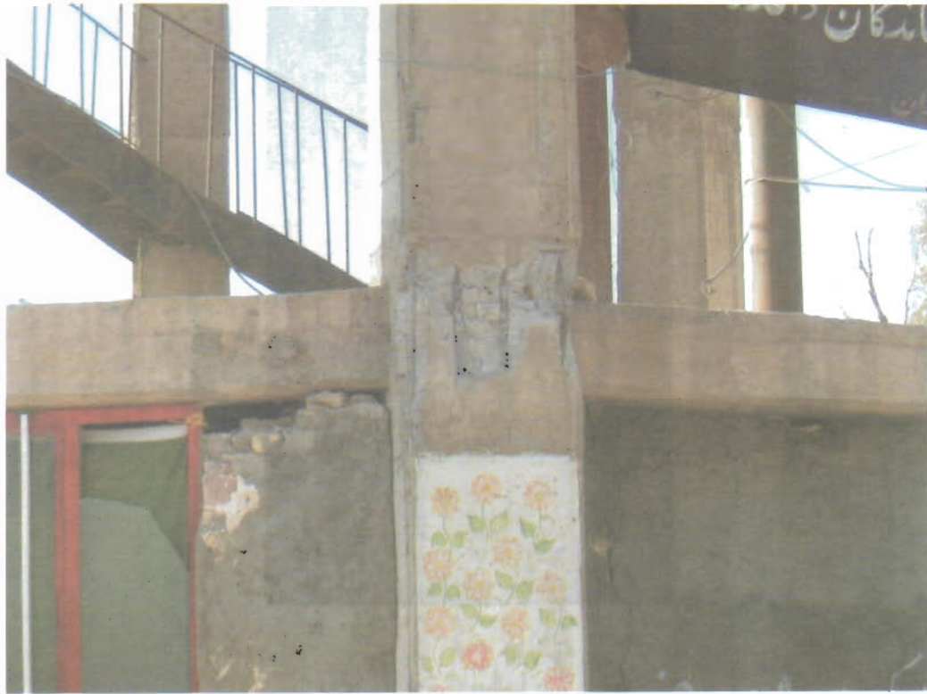
عملکرد خوب بتن (هسته مرکزی به علت آرماتوربندی صحیح و بتن خوب سالم و فقط کارور آن خراب است)
