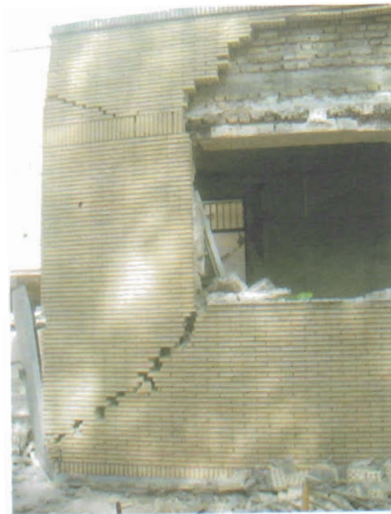
عدم رعایت اصول نماسازی توسط آجر ( به جزئیات نماسازی مراجعه فرمایید )
