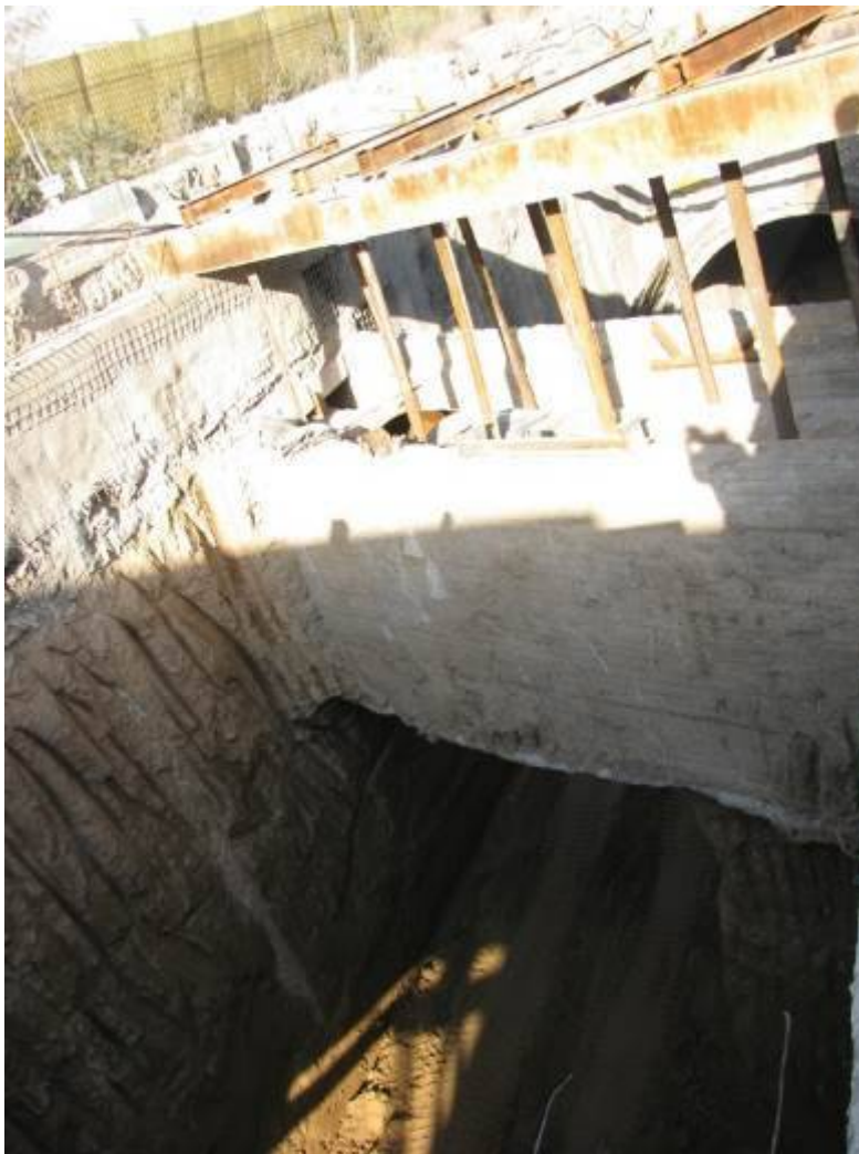
شکل ۵- تداخل با کانال‌های زیرزمینی حین اجرای تونل به روش کند و پوش (فرزانه، ۱۳۹۱)
