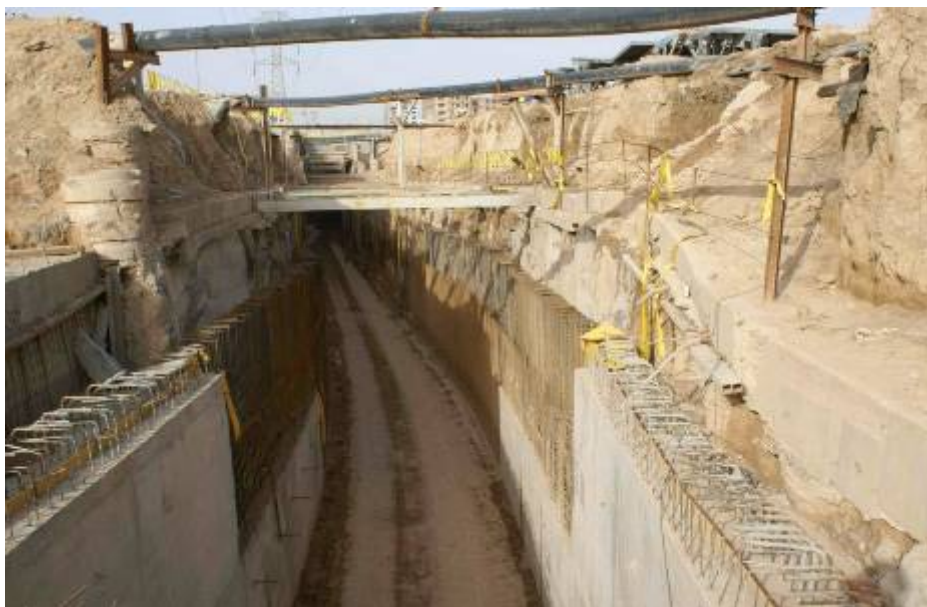
شکل ۲۷- وجود تأسیسات رو و زیرزمینی در تلاقی با محل احداث ایستگاه‌های مترو اهواز و نحوه نگهداری (باقری نیا ۱۳۹۱)
