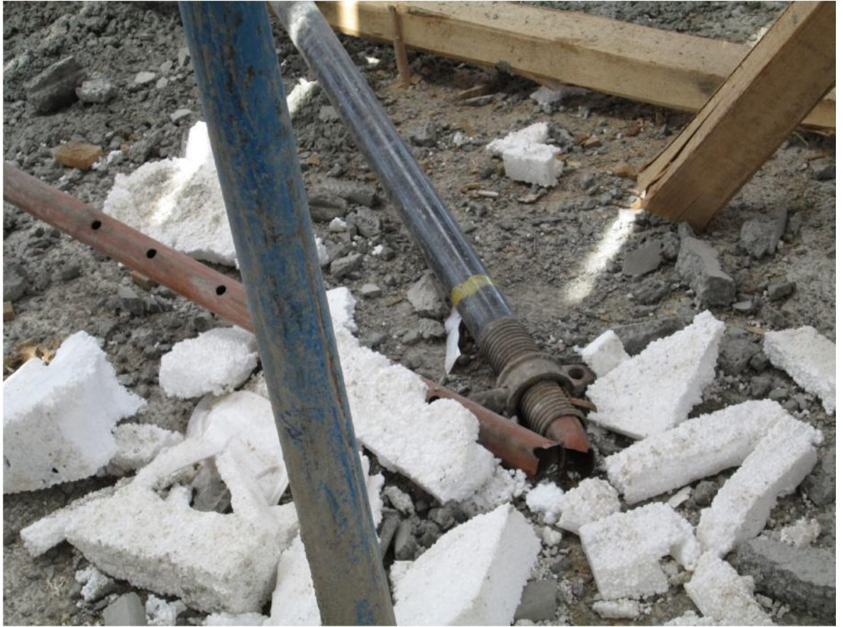
گسیختگی جک های فلزی
