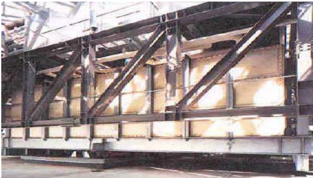
شکل (۱۳) - تانکهای ذخیره یخ برج کریستال
